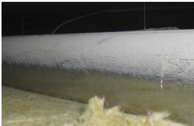
Kuva 18. Alakattojen takana mm. talotekniikan putkien pinnoilla havaittiin runsaasti rakennusaikaista pölyä.
