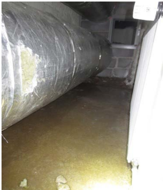
Kuva 8. Kellarissa teknisen tilan lattialla havaittiin irtovettä ja tilasta pystykuilu seuraavan kerroksen luokkaan.
