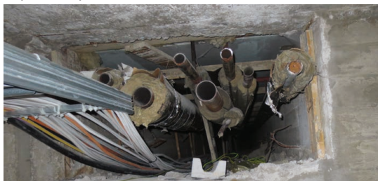
Kuva 9. Talotekniikkakanaalissa havaittiin useita vanhoja talotekniikan putkia, joita ei ollut tulpattu umpeen.
