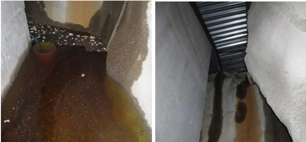
Kuvat 14 ja 15. Huoltotunnelin maanpinnalla oli irtovettä ja kallioseinäpinnoilla havaittiin valumavesiä.
