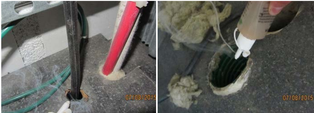
Kuvat 23 ja 24. Sähköpääkeskuksen maanvaraisen laatan alapuolelta tulevat läpiviennit ovat tiivistämättömiä samoin kuin kerrosten välissä olevien välipohjien läpivinnit.
