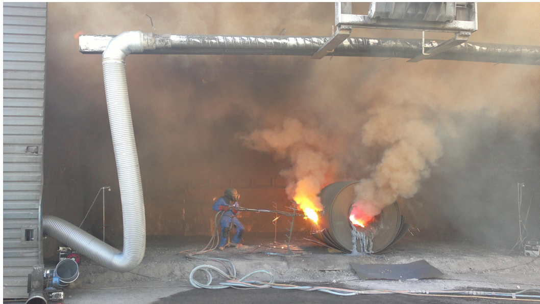
Kuva 17. Vaakasuuntaista puhallussuihkua kokeiltiin eri korkeuksilla haarukkatrukin kannatella puhallusosaa. Tasainen ja riittävän voimakas puhallussuihku auttoi ohjaamaan polttoleikkauksessa muodostuvia savuja kohti poistoa.
