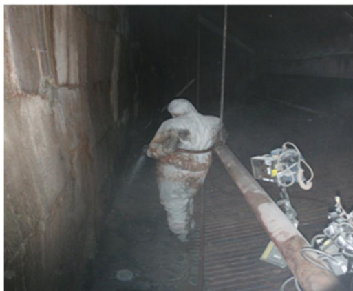
Kuva 14. Tulikynnys, kattilan sisäosan pesu.
