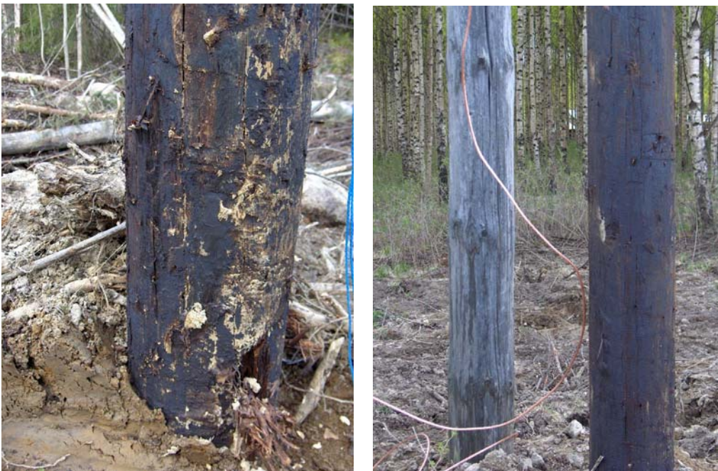
Kuva 7. Kreosoottikylläste voi olla paksuna kiinteänä kerroksena pylvään pinnalla.
