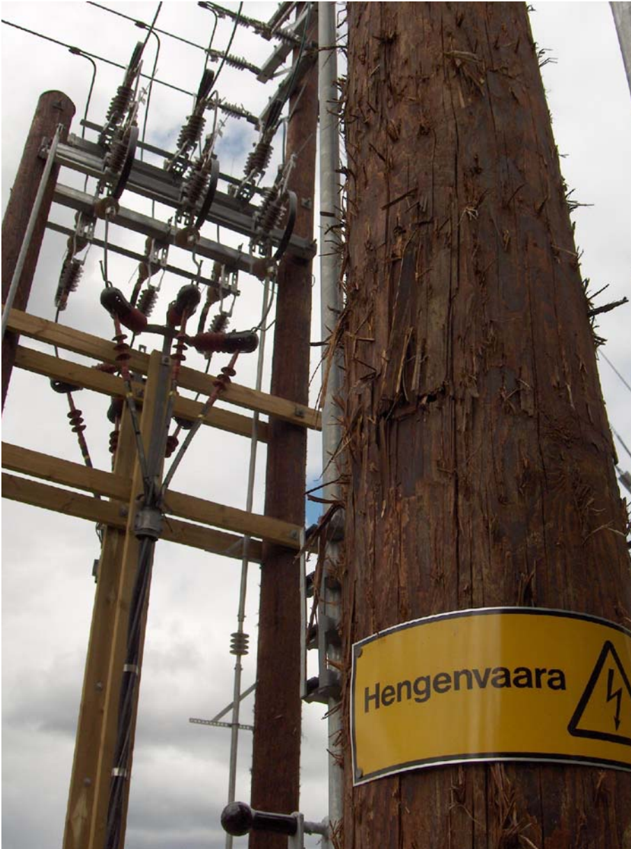
Kuva 11. Tolppakenkien irrottamia tikkuja kreosoottipylväessä.
