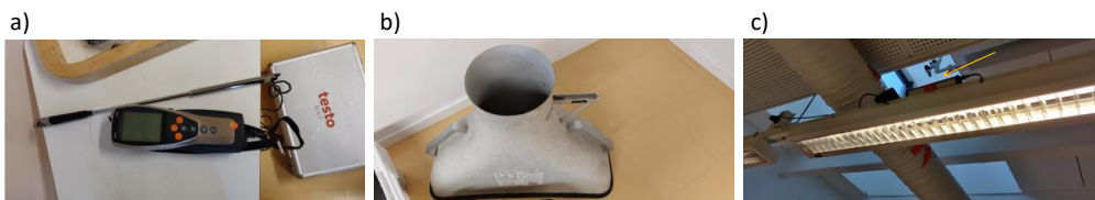
Kuva 1. Ilmanvaihtojärjestelmän päätelaitteen mittauslaitteita: a) Anemometri ilman nopeuden mittaukseen. b) Ilmanohjaukseen käytettävä torvi, jonka sivussa on reikä mittausanturille. c) Swema 3000 tallentamassa mittausdataa tuloilmakanavasta valaisimen päällä.
