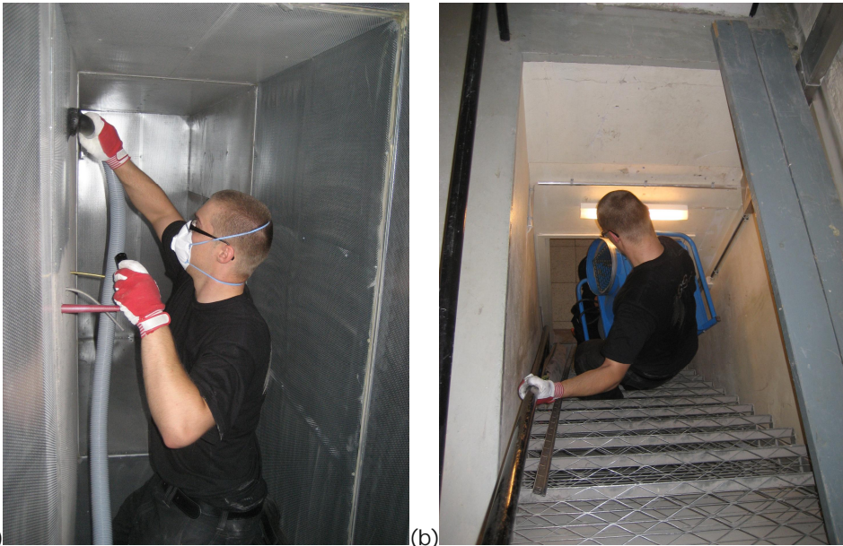
Kuva 4.1. Puhdistajan työskentely riskialttiissa paikoissa: (a) Poistoilmakoneen kammion puhdistaminen ahtaassa kammiossa. (b) Alipaine- ja suodatinyksikön kuljettaminen kaapeiden ja jyrkkien portaiden kautta.
