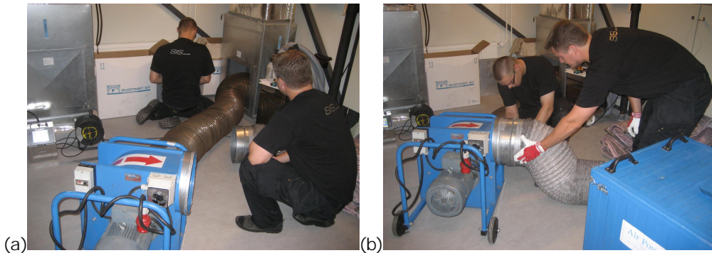
Kuva 4.3. (a) Alipaineyksikön imuputken kiinnittäminen puhdistettavaan tuloilmakanaviin. (b) Alipaine- ja suodatinyksikön liittäminen sarjaan ilmanvaihtokonehuoneessa.
