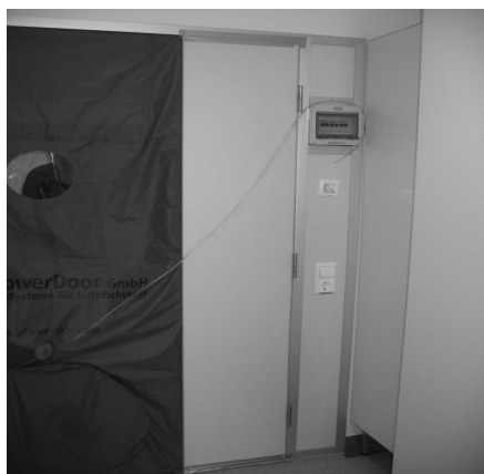
Kuva 6.16. Käytävän oven tiivistämätön sivupaneeli.
