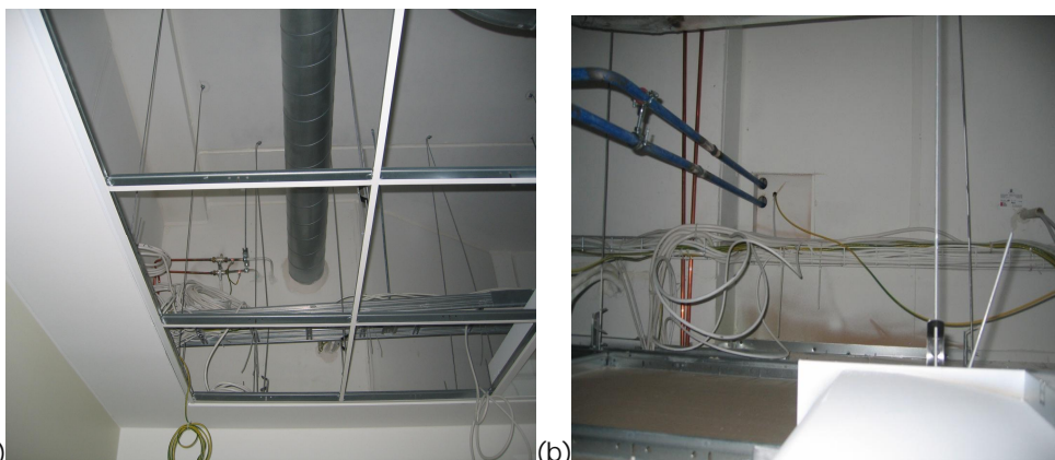
Kuva 6.15 (a) Hyvin tiivistetty kanavan läpivienti. (b) Jälkeenpäin tehdyt putkien läpiviennit ovat jääneet tiivistämättä.
