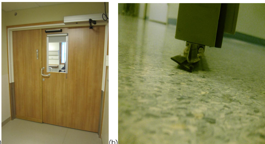
Kuva 6.12. (a) Heikkorakenteinen vääntynyt ovi. (b) Oven alaosan rikkoutunut tiivistysmekanismi.
