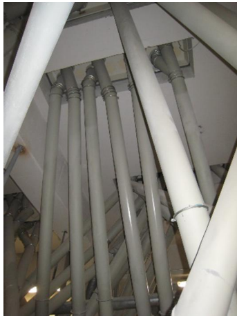
Kuva 12. Toisen kerroksen putkia
