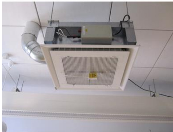
Kuva 8. Sisäilmaa puhdistava Ilmanjakolaite asennettuna toimistohuoneeseen (koekohde B, Swegon Parasol C)
