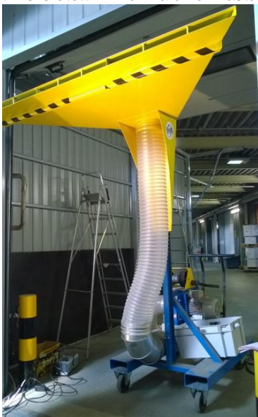
Kuva 5. Konttien tuulettamiseen suunniteltu ja testeissä käytetty keskipakopuhallin.
