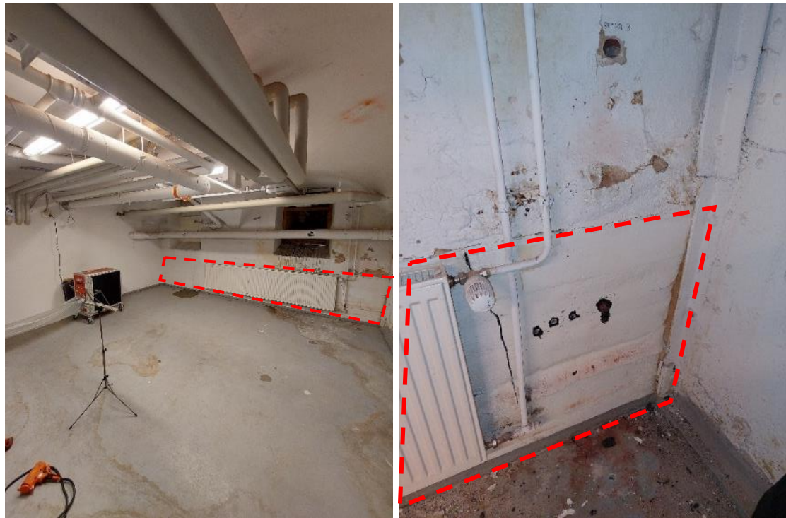
Kuva 15. Tutkittu tila 3.1.1, valuasfaltin sijainti maanvastaisella seinällä rajattu punaisella katkoviivalla. Aiempien tutkimusten jäljiltä olleet rikkonaiset pinnat paikattiin ennen hankkeen tutkimuksia.
