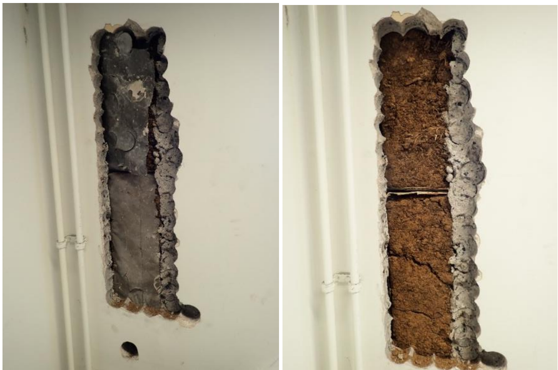
Kuva 20. Ulkoseinä rakenteen sisällä olevien eristeharkkoja ennen ja jälkeen tervapaperin irrotuksen.
