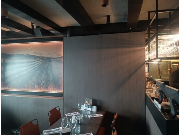
Kuva 2.4. Grill House -ravintolan seinäpintaa, josta mikrobiologinen näyte otettiin.
