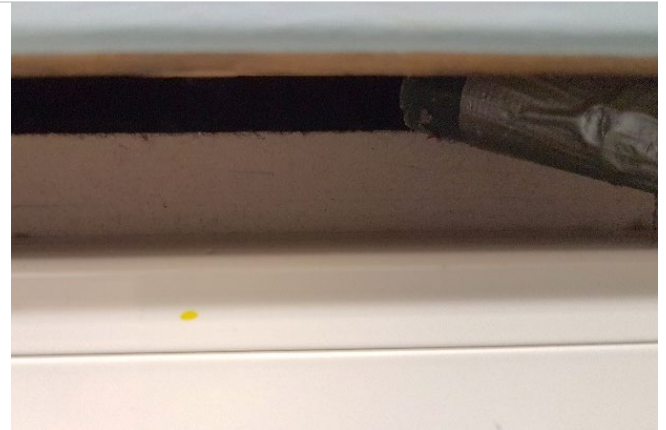
Kuva 61. Todellisessa kohteessa ikkunaliitoksessa usean metrin matkalla todettu n. 1 cm levyinen rako ulkoseinän eristetilaan.
