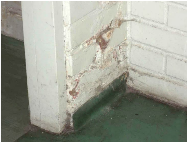
Kuva 8. Kuntoarviomenetelmin havaittavissa oleva sisäpinnan korjaamaton kosteusvaurio.
