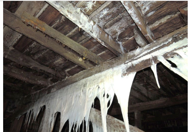
Kuva 13. Kuntotutkimusmenetelmin todettu vaurio kulku-yhteydettömässä alapohjassa.
