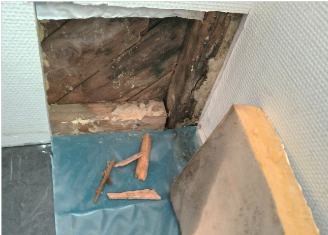
Kuva 12. Kuntotutkimusmenetelmin todettu kosteusvaurio kuvan 11 seinärakenteessa.
