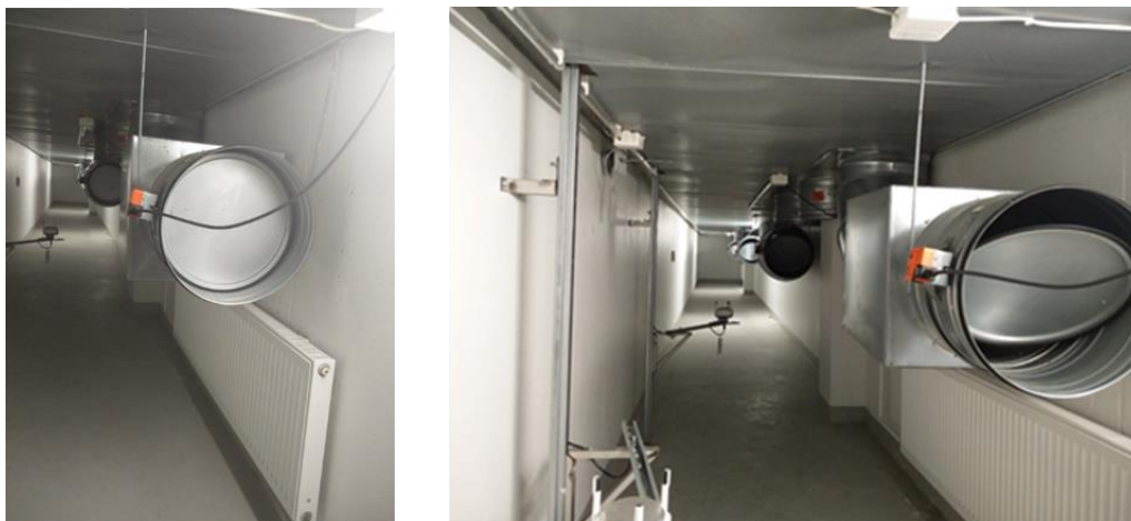
Kuva 25. Luokkaan johtavan tuloilmakanavan alkupää raitisilmakammiossa. Alkutilanteessa (kuva vas.) säätöpelti oli pääasiassa täysin kiinni. Ilmanvaihdon parannuksen jälkeen säätöpelti oli perustilassa vähintään 20 % auki (kuva oik.) (Vornanen-Winqvist, Ahmed et al. 2017).
