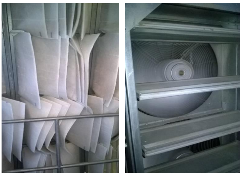
Kuva 6. Tuloilmakoneen suodatin (vasen kuva), tuloilman avustinpuhallin (oikea kuva).
