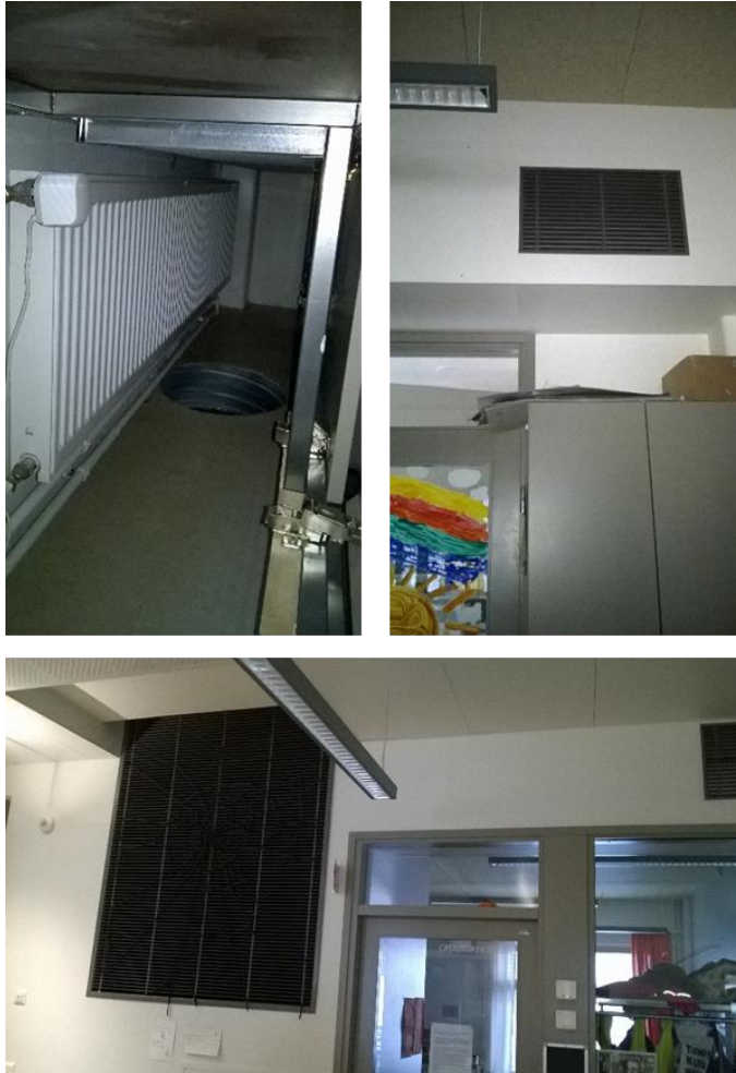
Kuva 7. Tuloilmakanavan pää luokassa ikkunan alla sijaitsevassa tilassa (kuva ylhäällä vasemmalla), käytävään johtava siirtoilmasäleikkö luokan seinän yläosassa (kuva ylhäällä oikealla) ja poistoilmatornin ritilä aulassa (kuva alhaalla).
