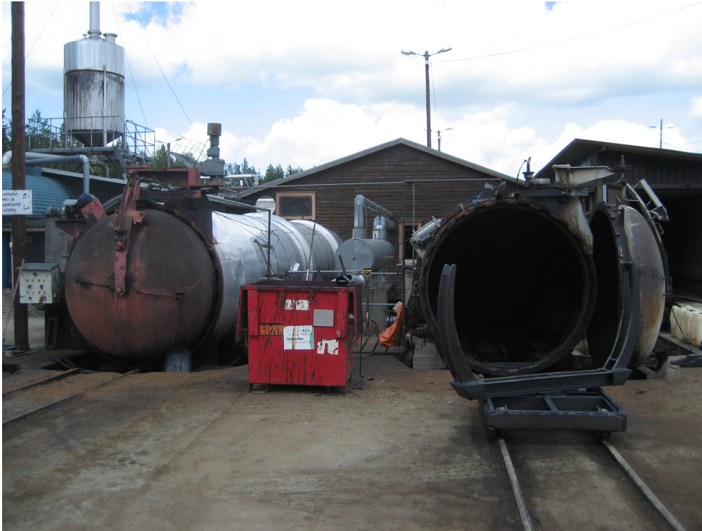
Kuva 4. Kyllästyssylinterit. Vasemmanpuoleinen sylinteri avataan koneellisesti; ohjauslaite näkyy sylinterin oven vasemmalla puolella keskivaiheilla. Oikeanpuoleisen sylinterin ovi avataan käsin.
