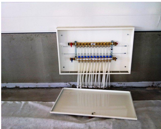
Kuva 10. Hallin lattian lämmitysputkiston jakotukki
