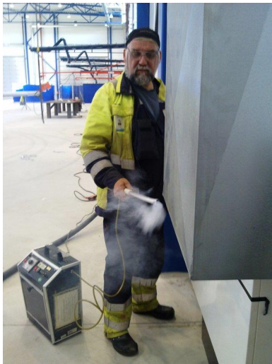
Kuva 1. Voimakas ilmavirtaus tuloilmalaitteen alaosaan
