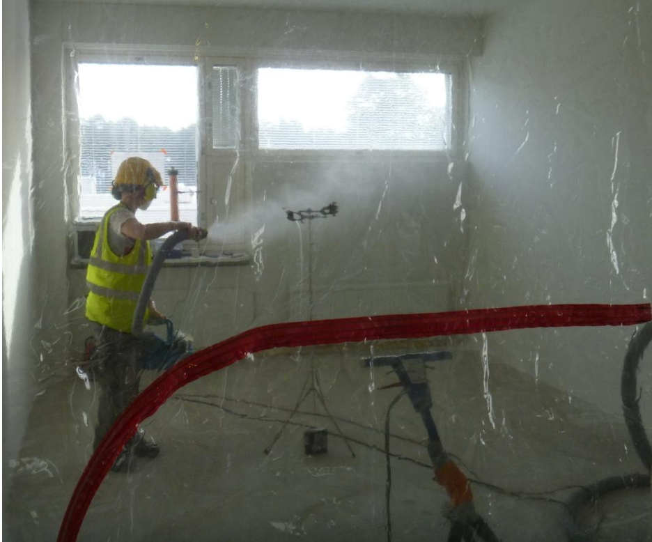
Kuva 9. Vesisumutus sairaalan 2 tutkimustilassa.
