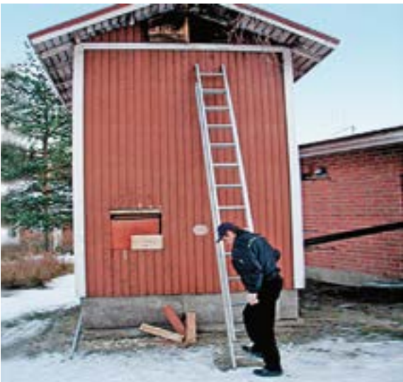
Kuva 4. Hankala kulkureitti pelletin varastosiilon (myös hankala päästä pois ja tehdä pelastustoimenpiteitä) (YTOT 2/08).
