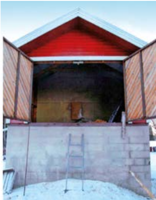
Kuva 10. Liite 1 – tapauksen hakesiilo.
