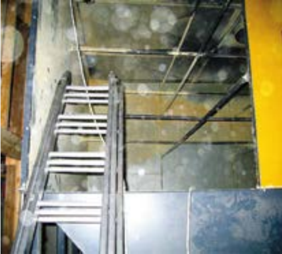
Kuva 1. Pelastuslaitoksen tekemä aukko siilon kylkeen (YTOT 3/08).
