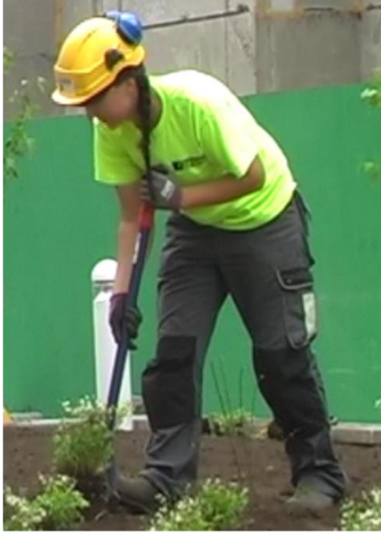
Kuva 13. Kuoppien kaivamisessa lapiolla istutettaville perennoille esiintyy selkää kuormittavia kumaria ja kiertyneitä asentoja.
