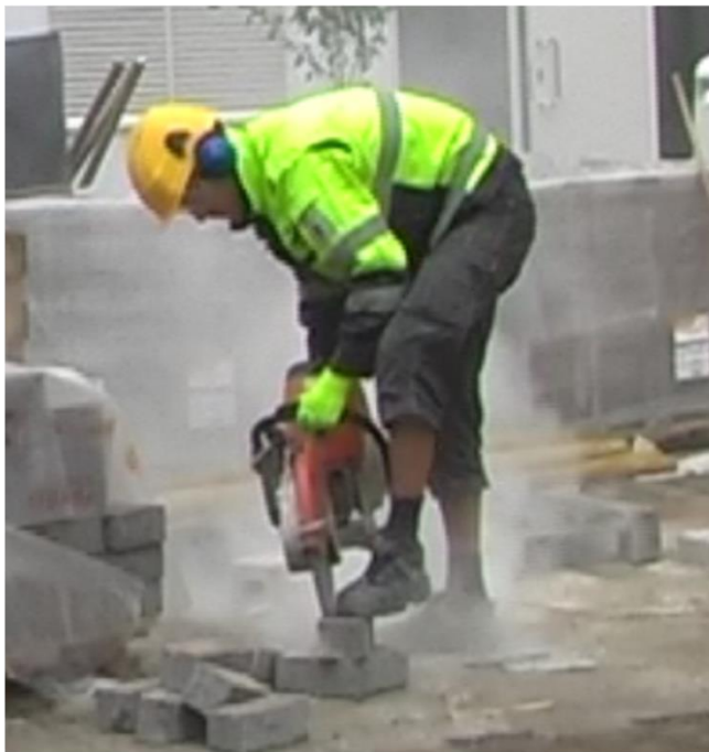
Kuva 16. Kiven halkaisussa laikalla esiintyy selkää kuormittavia kumaria asentoja. Paino kohdistuu toiselle jalalle, ja kiven paikoillaan pitäminen jalalla aiheuttaa tapaturman vaaran.
